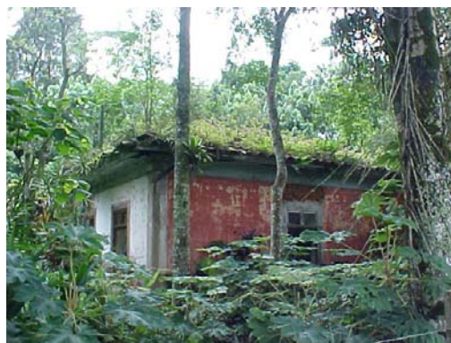
7. Casa de Taipa de Pilão abandonada, construída no século XIX. Antiga Estrada do Curucutu.
